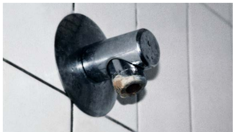
Bild 3 • Duschkopf mit Ablagerungen
