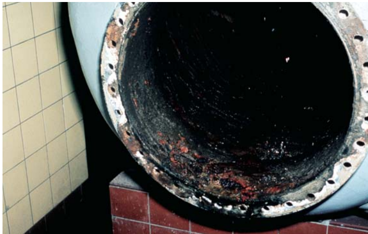
Bild 1 • Rostablagerungen in einem Speicher
