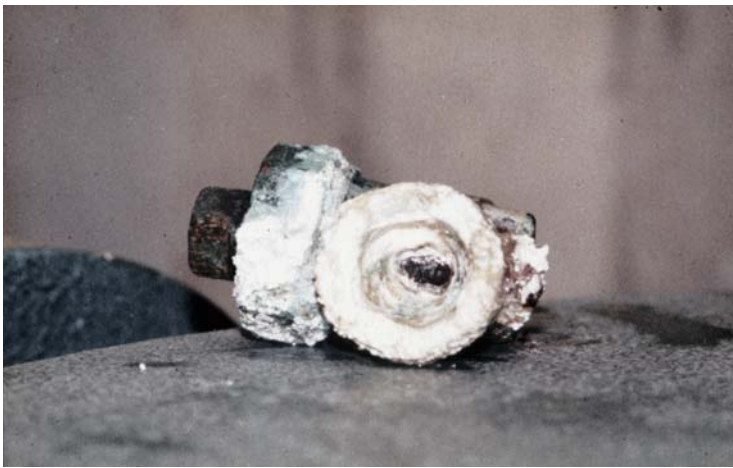
Bild 3 • Bilder von Missständen können ebenfalls die Aufklärungsarbeit unterstützen. Abgerissener Ablasshahn mit starken Inkrustierungen. Foto:Dr. Pleischl, Bonn
