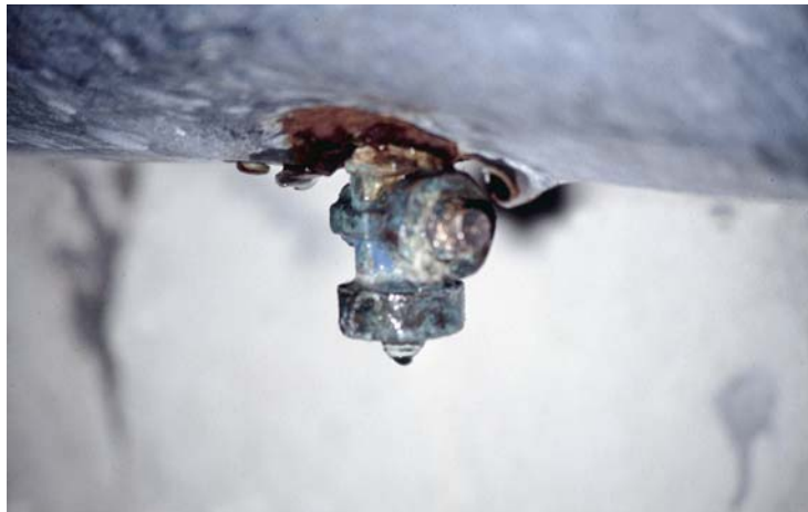
Bild 1 • Tropfende Rohrleitungen, Rost oder sonstige sichtbare, äußerliche Veränderungen an Anschlüssen, Leitungen und Verrohrungen sollten jedem zu denken geben - dem Installateur genauso wie dem Endverbraucher. Undichter Ablasshahn an einem Speicher. Foto:Dr. Pleischl, Bonn
