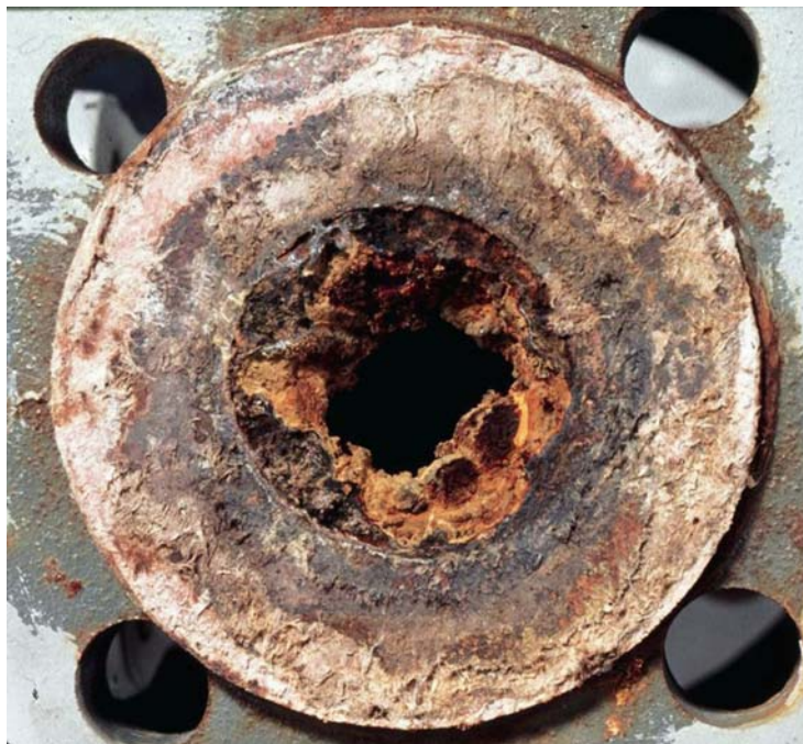
Bild 2 • Hier besteht Handlungsbedarf! Immer wieder stoßen die Hygieniker auf derartige Zustände in der Hausinstallation. Eisen-Rohr mit Inkrustierungen. Foto:Dr. Pleischl, Bonn
